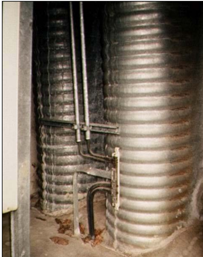
Abb. 3-12: Potentialausgleich-Schiene an der inneren metallenen Gewölbe-Auskleidung
