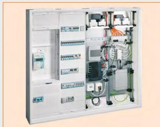
Bild 2: Zählerschrank mit Multimediaverteilerfeld
